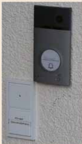
elektronische Türüberwachung Pfarramt
